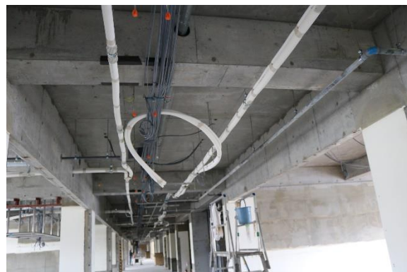
(天井の配線・配管の様子)
